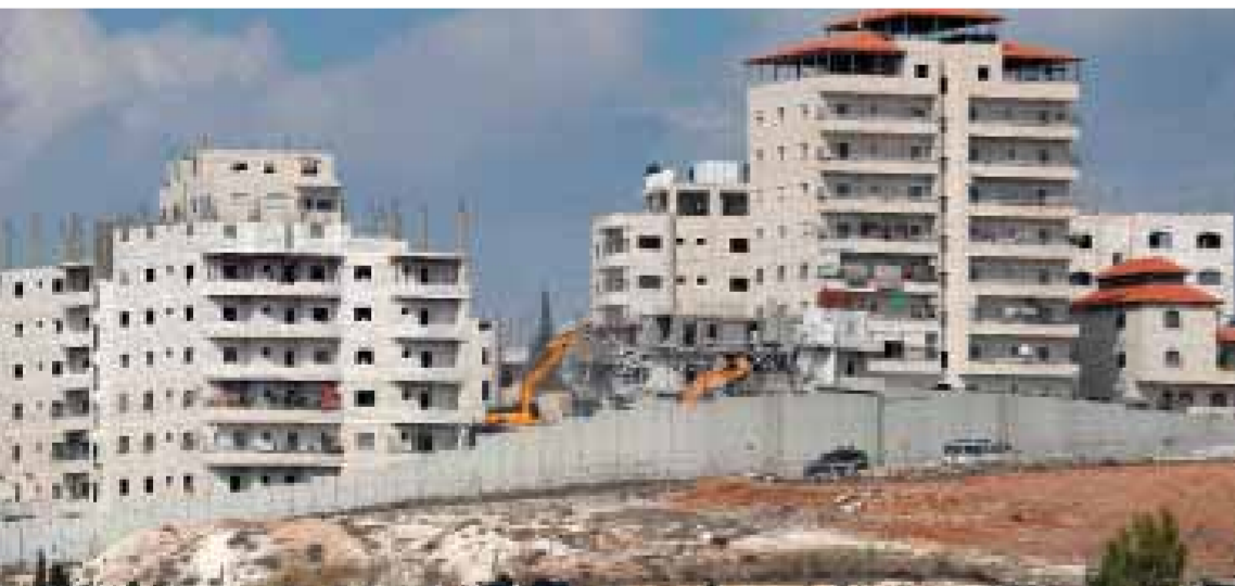
قوات الاحتلال الإسرائيلي تهدم منزل أحد الفلسطينيين يقع خلف جدار الفصل الإسرائيلي قرب شغاف في القدس الشرقية المحتلة (أس.أ.ف.ب)
